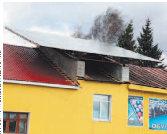
Солнечная электростанция на крыше здания «Региональной энергетика».
