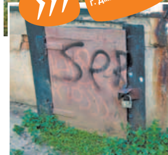
Ул. Школьная, д. 7. Дверь в подвал.
